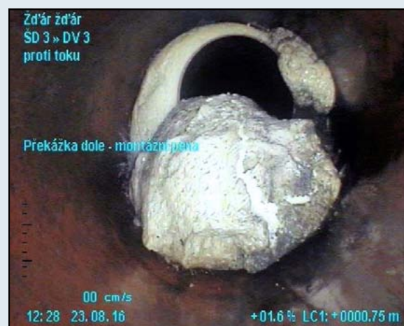
Foto: montážní pěna v kanalizaci
